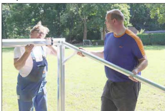
André und Jens bei der Montage. Im Hintergrund das Gebäude des Jugendclubs. Foto: I. B.
